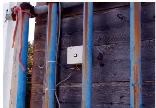
東側ゲート解錠ボタン
